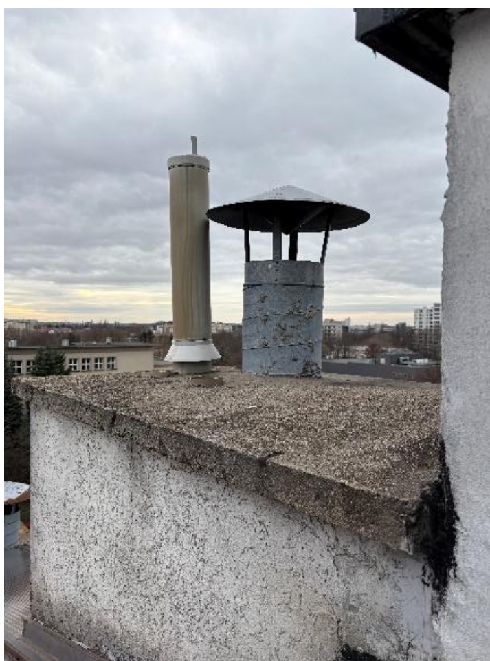
Bitwy Warszawskiej 1920 r. nr 18 – komin, pas elewacji do naprawy
