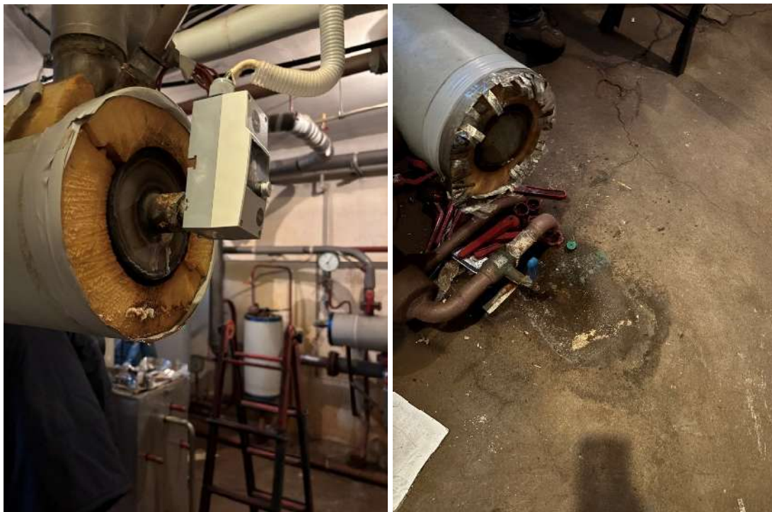
Bitwy Warszawskiej 1920 r. nr 18 – przeciek na instalacji węzła C.O.
