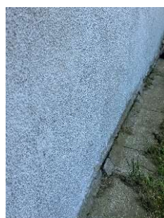
Rzymowskiego 33 – opaska wokół budynku na wysokości VI klatki schodowej
