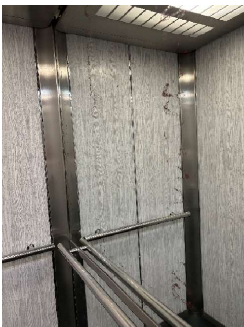
Rzymowskiego 19 – I klatka schodowa – lustro w dźwigu osobowym
