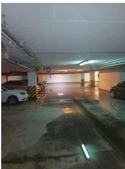
Komorska 11/15 – zalanie garażu po nawałnicy
