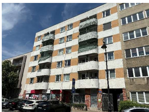
Narbutta 4 – siatka zabezpieczająca na balkonach
